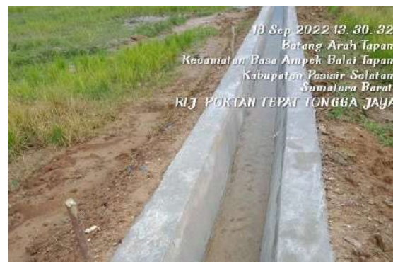
Pembangunan/Rehabilitasi Jaringan Irigasi Tersier di Nagari Talang Koto Pulai Tapan, Kecamatan Ranah Ampek Hulu Tapan
